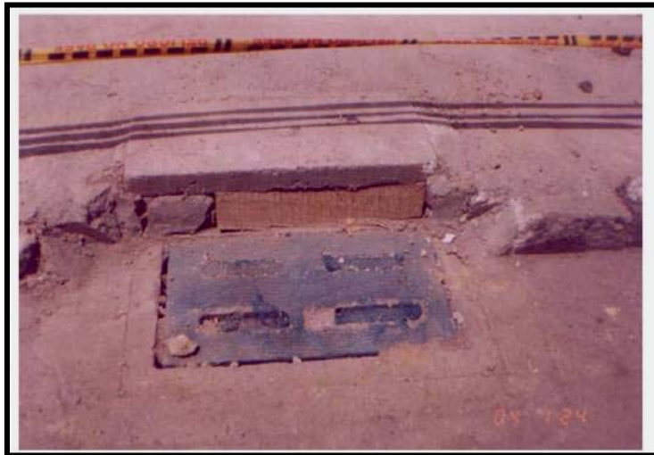
Foto D7.1 Protección de Sumidero: Obsérvese el estado deteriorado de la malla, debe usarse geotextil en la tapa y en el interior. (Adecuación de la Troncal NQS de Transmilenio en Bogotá)
