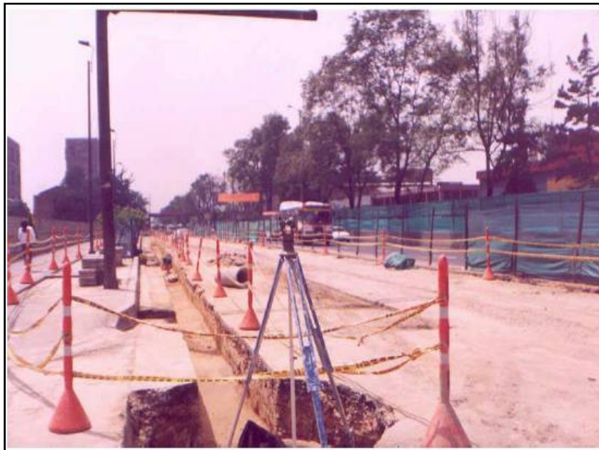
Foto 8.1 Aislamiento de una excavación (Adecuación de la Troncal NQS de Transmilenio en Bogotá)
